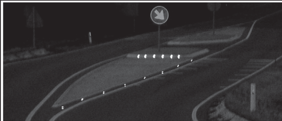
De fietsoversteekplaats op de N513: de vluchtheuvel is gemarkeerd door middel van betonbanden met LED-elementen, en langs de verdrijvingsvlakken zijn LED-units in het asfalt aangebracht. Foto: Imtech Nettenbouw
