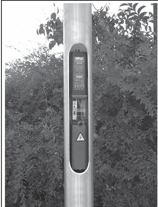
De intelligente electronicamodule in iedere lichtmast zorgt voor het dimmen en schakelen van het betreffende lichtpunt. Ook geeft de module statusmeldingen door aan de centrale commandopost. Foto: Elspec
